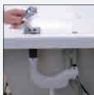
Tuyau de drainage anti - goutte
