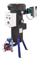
4 Équipements de chaufferie
